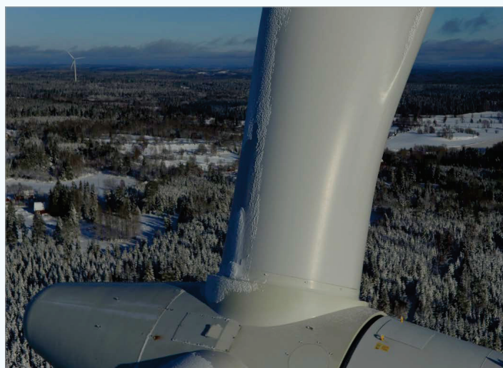
Isbildning på vindkraftverk
