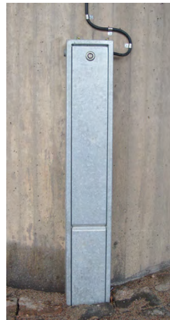
Säkringscentral, sk "Larssonskåp"
