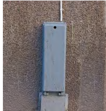
Utanpåliggande säkringscentral sk "Göteborgsdosa"
