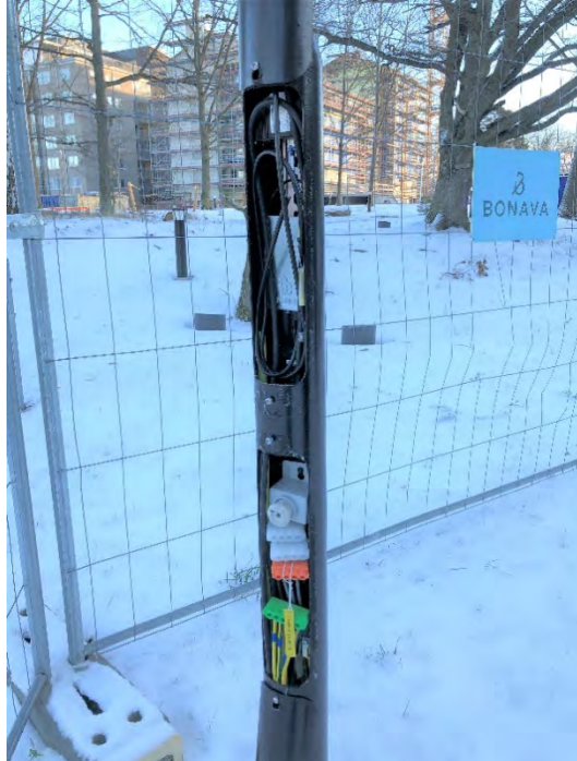
Stolpe med dubbla luckor, (säkring för armatur saknas)
